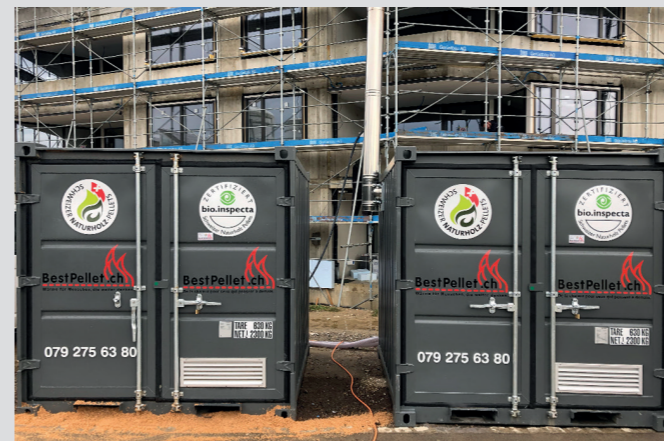
Container nebeneinander platziert: Brennstoff-Box und Wärm-Box
