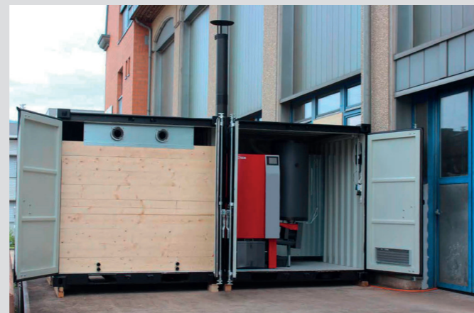
Blick in das Innere der Container: Pelletlager links und Pelletheizung rechts
